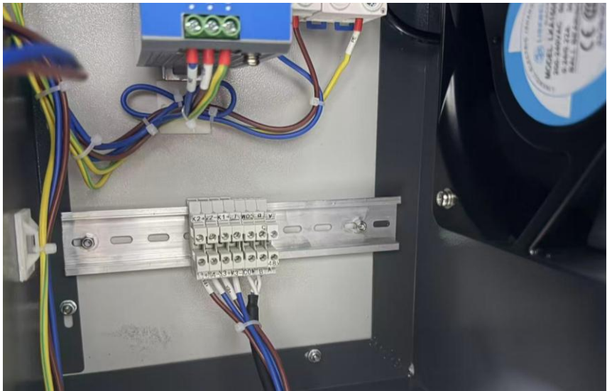
2-10 增氧泵接线端子
